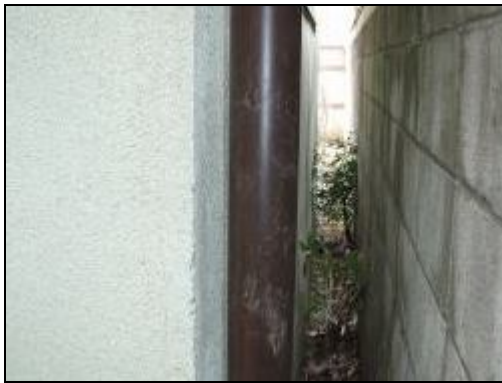
雨樋から屋根に登っている例
