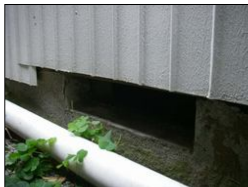
床下換気口破損箇所
