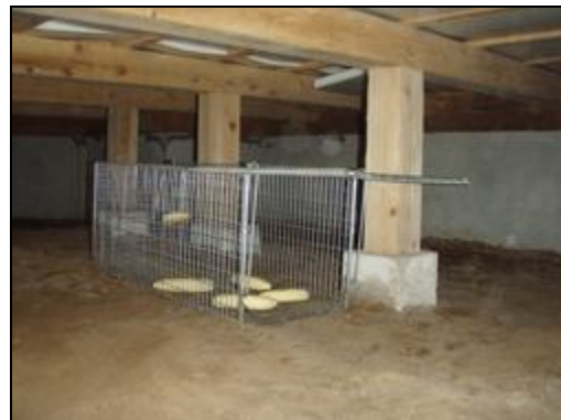
床下への設置
