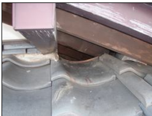
屋根接合部分の隙間
