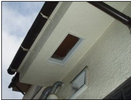
軒下の換気口破損箇所
