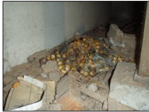
カビが発生した床下の糞
