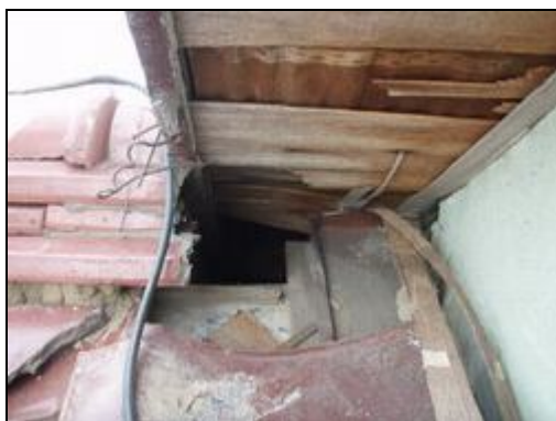
屋根裏侵入のため広げられた穴
